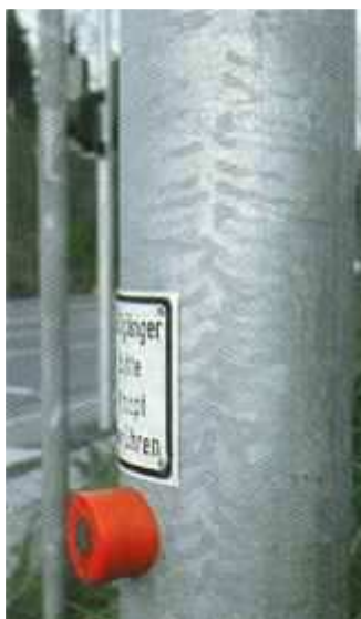
Abb. 2: Minimaler Weißrost an einem Signalmast; für die Wirksamkeit des Korrosionsschutzes ohne
