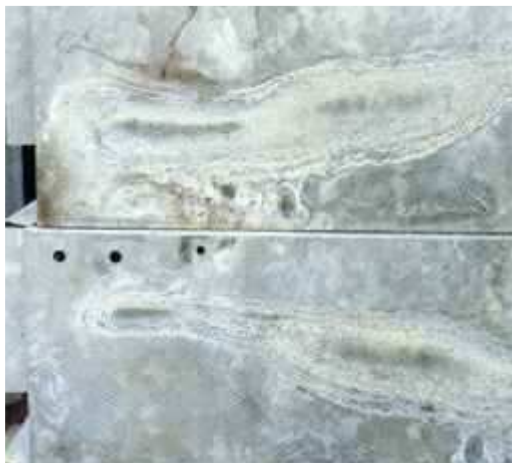
Abb. 1: Feuerverzinkte Bauteile, die mehrere Monate im Freien lagerten. Die enge Stapelung verhinderte eine ausreichende Luftzirkulation, so dass eine Weißrostbildung ausgelöst wurde
