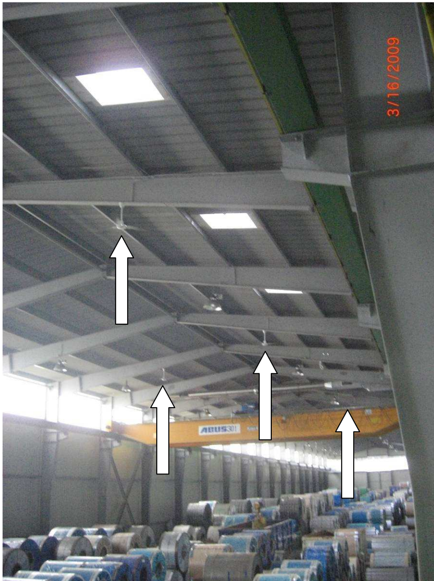
Beispielbild: Deckenventilatoren in 2 parallelen Reihen in einer Coillagerhalle angeordnet
